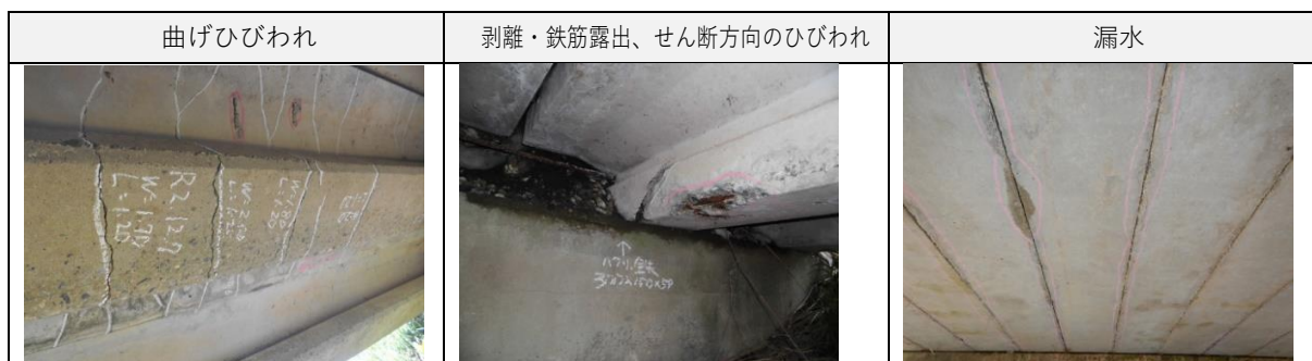
図 2-8 小規模橋梁の代表的な損傷
