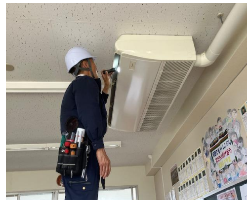
設備保守点検
