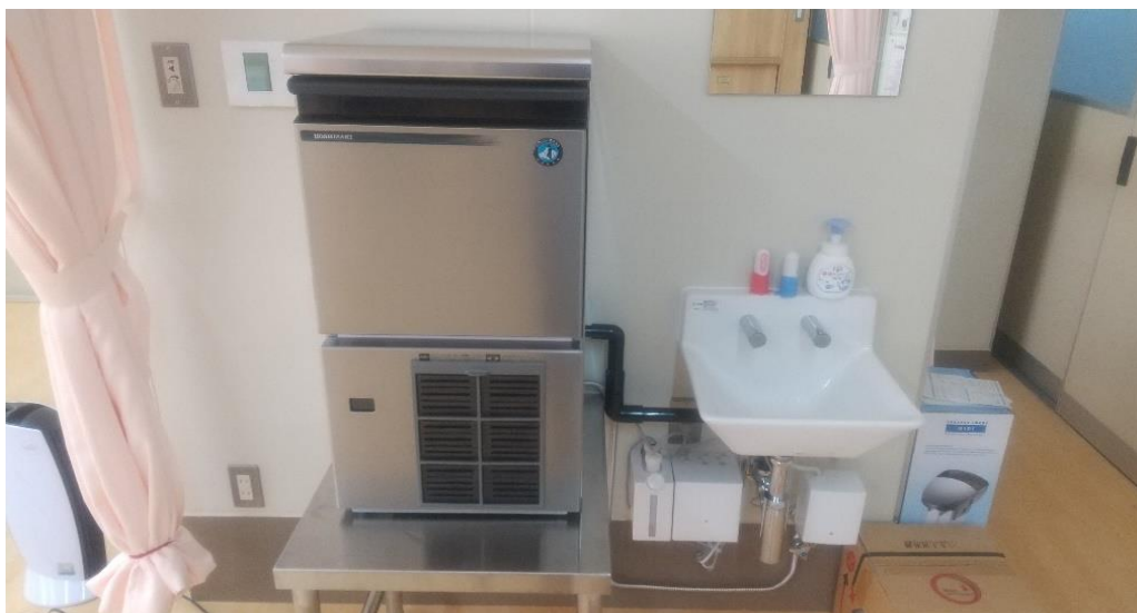
《古里小学校保健室に設置した製氷機》
