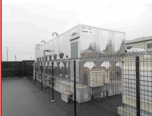
（耐震性貯水槽）
