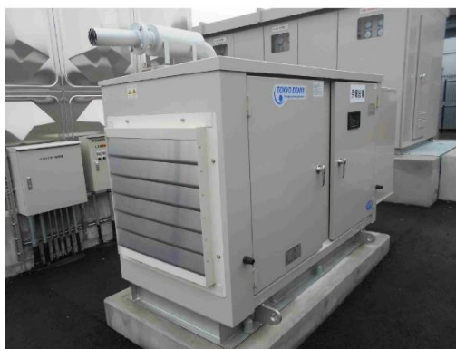
（非常用発電装置）
