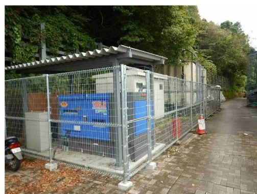
（非常用発電装置）
