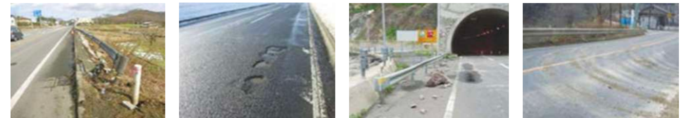
標識などの損傷
