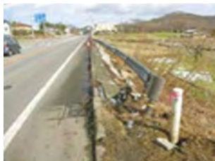
標識などの損傷
