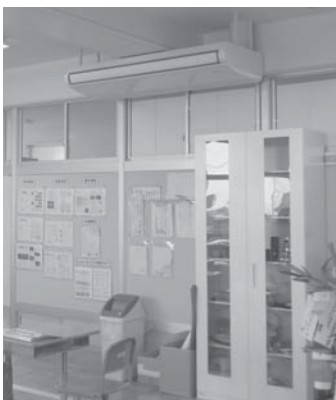
下館西中学校に設置されたエアコン
