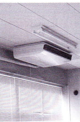
小学校設置エアコン
