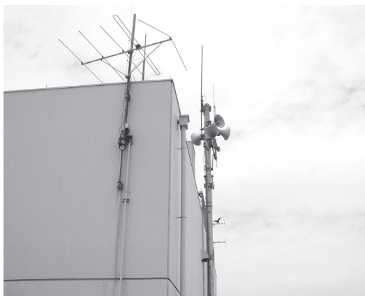
防 災 無 線 (市役所屋上)
