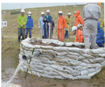
▲堤防から吹き出した水のはけ口が広がるのを防ぐ伝統的な工法「月の輪」
