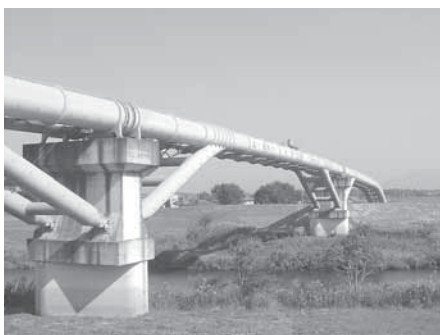
霞ヶ浦用水配水管
