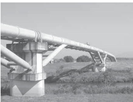
霞ヶ浦用水配水管
