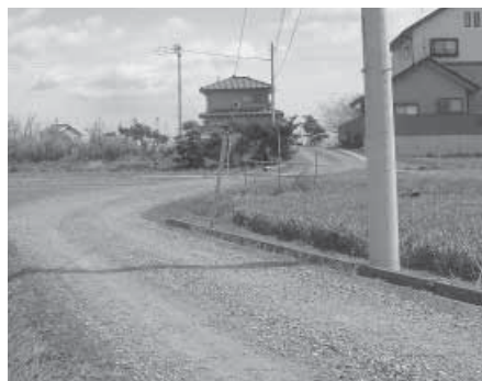
早期の舗装が望まれる小川地内市道
