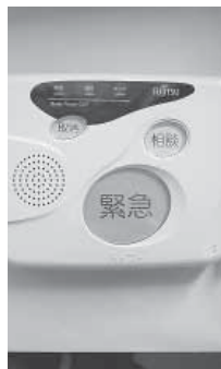
緊急通報装置
