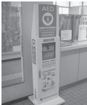
市役所本庁1階に設置されているAED
