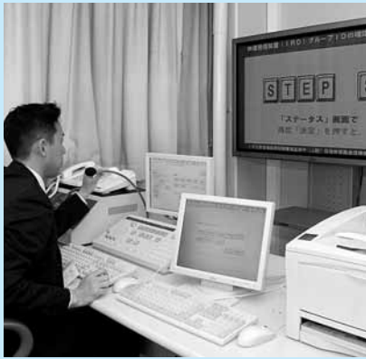
【新しく整備した防災行政無線室】
