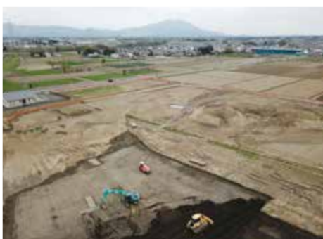
▲国道50号下館バイパス沿い(川澄)の建設現場。南東方向に筑波山を望み、周囲を田んぼに囲まれる優れた景観。
